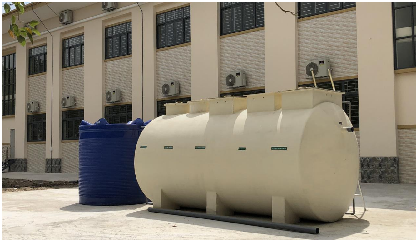
HỆ THỐNG XỬ LÝ NƯỚC THẢI TRUNG TÂM Y TẾ
