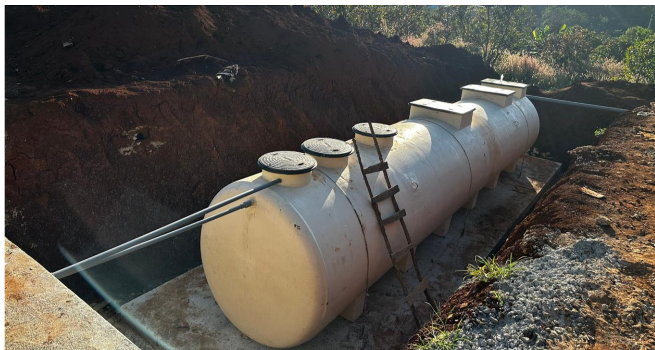
HỆ THỐNG XỬ LÝ NƯỚC THẢI NHÀ HÀNG, KHÁCH SẠN
