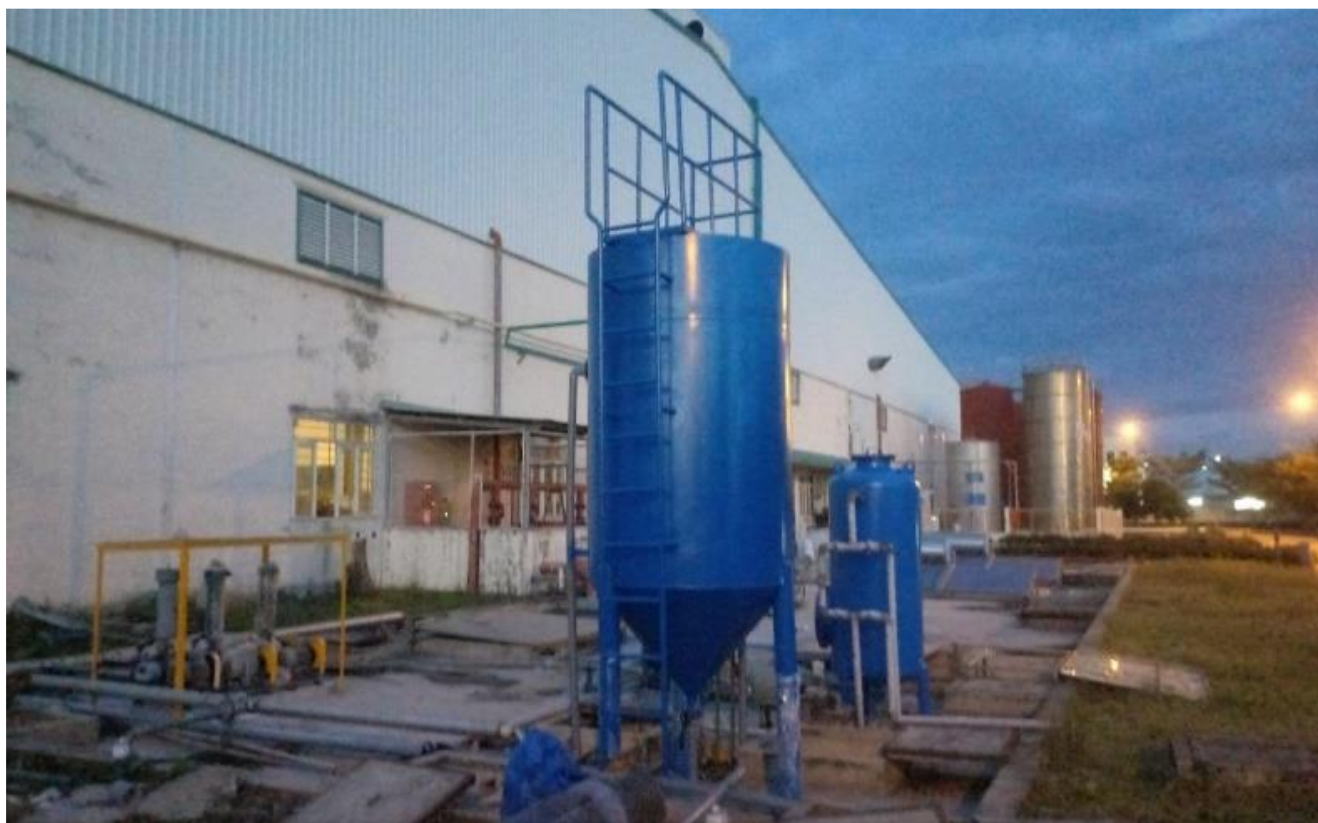
HỆ THỐNG XỬ LÝ NƯỚC THẢI BÚN, MÌ, TINH BỘT
