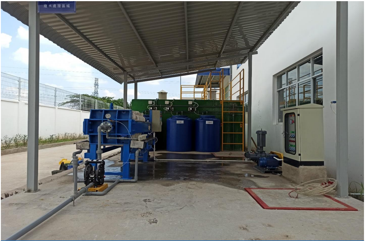
HỆ THỐNG XỬ LÝ NƯỚC THẢI NGÀNH MAY, CÔNG NGHIỆP
