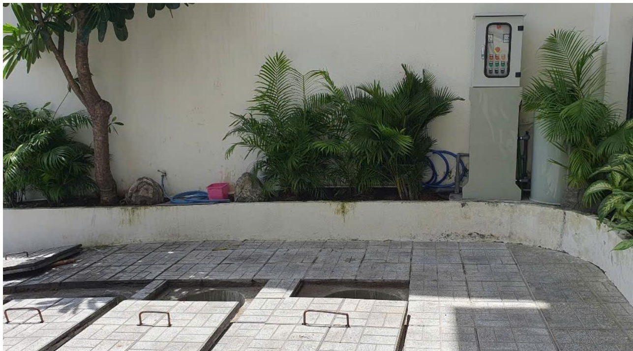
HỆ THỐNG XỬ LÝ NƯỚC THẢI CHUNG CƯ, TÒA NHÀ, TTMM
